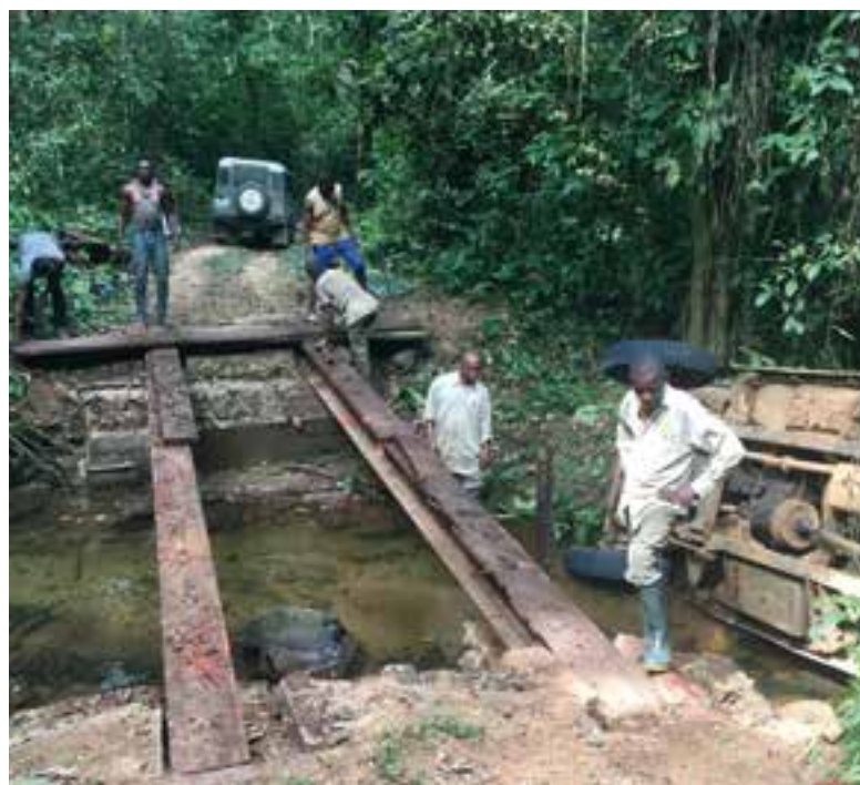
■ Zerstört: Der Sturm hat die Zufahrtsbrücke weggerissen
